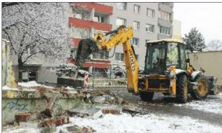
Stará chátrajúca dráha na ulici Karola Adlera padá k zemi. Jej zlý stav prekvapil aj stavebníkov počas búrania.
