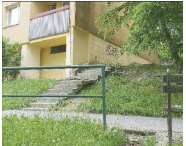
Zničené schodisko na Hanulovej ulici, ktoré sa má opraviť.
