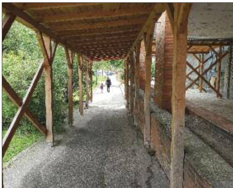
Drevená konštrukcia a zábrana pred padajúcou omietkou a časťami muriva pred ubytovňou ministerstva.
