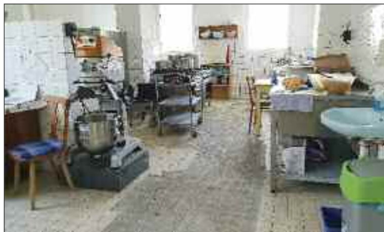
Kuchyňa v Materskej škole Cabanova musela riešiť havarijný stav dlaždíc.
