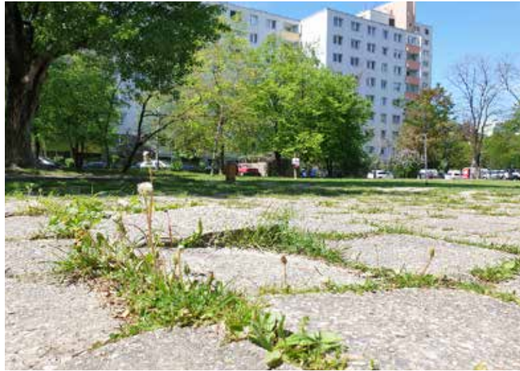
Dlažba je dnes nerovná, zlamaná, zničená.
