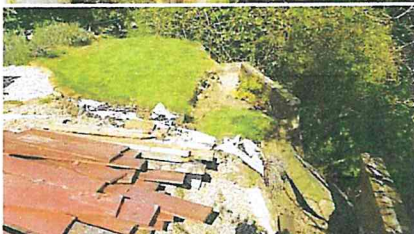
Pohľady na parcelu, zrútený oporný múr a zosunutú pôdu.
